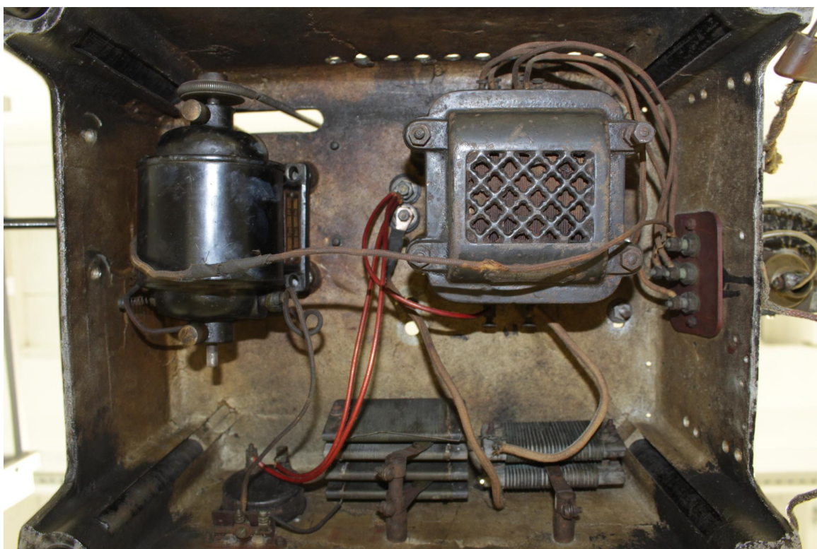
Foto completa da fiação dentro da base
