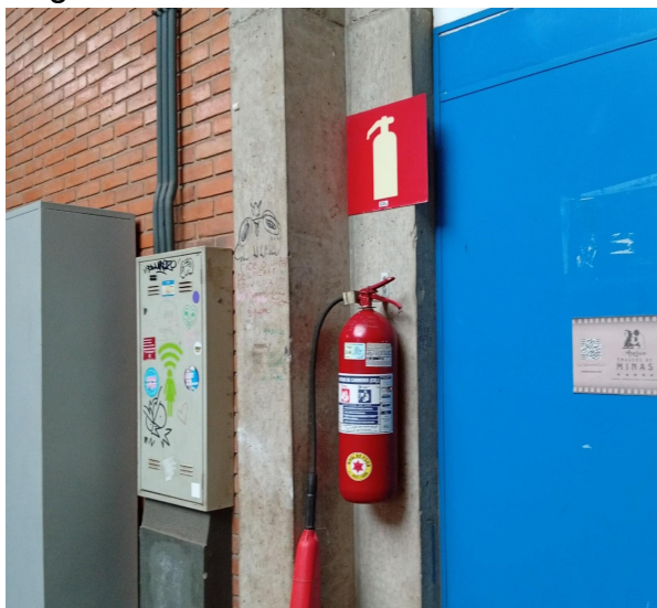
Figura 25 - Extintor de incêndio de CO2
