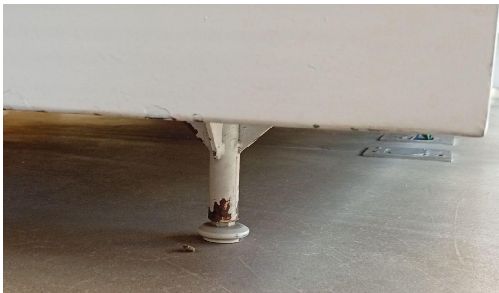
Figura 37 - Sinais de corrosão em áreas de abrasão e desprendimento do acabamento
