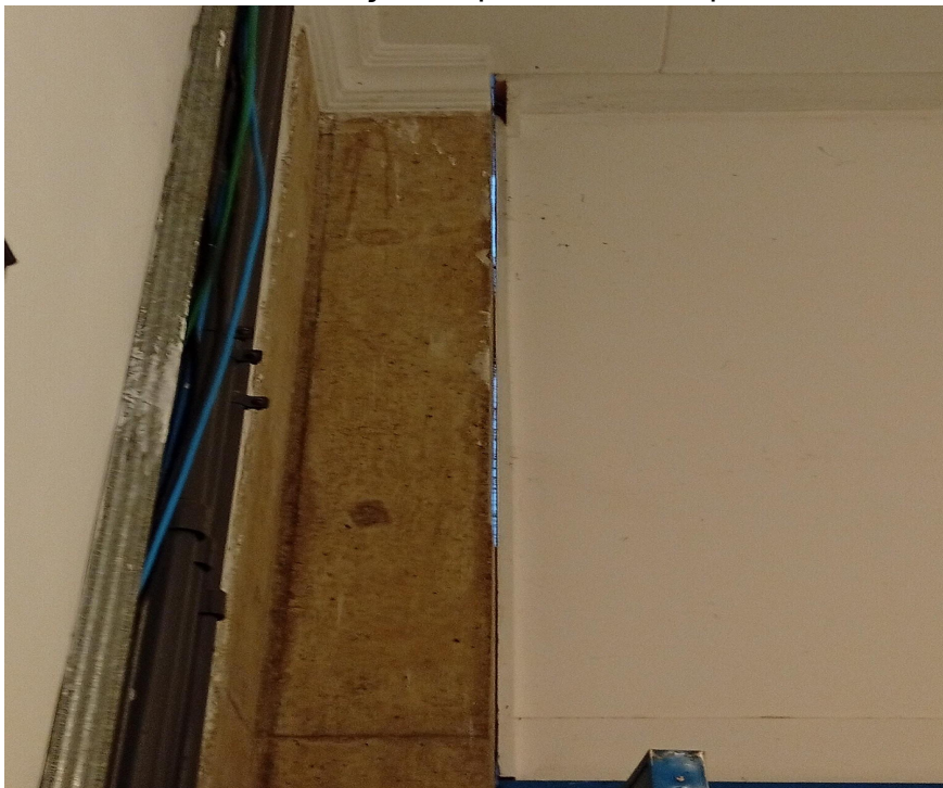
Figura 21 - Detalhe da má vedação da parede de compensado acima da porta
