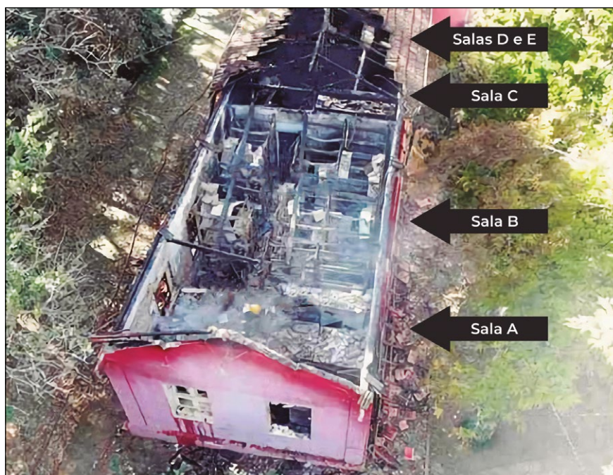
FIGURA 82 – Vista superior da Reserva Técnica 1, destacando as salas (A, B, C, D e E) afetadas pelo incêndio e a vegetação circundante.
