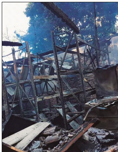
FIGURA 94 - Vista da sala B após a contenção das chamas pelo CBMMG. Fonte: Corpo de Bombeiro Militar de MG, 2020.
