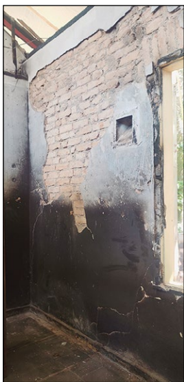
FIGURA 90 – Sala B: presença de fuligem na parede (parte inferior). Fonte: AGE Almada, 2020.
