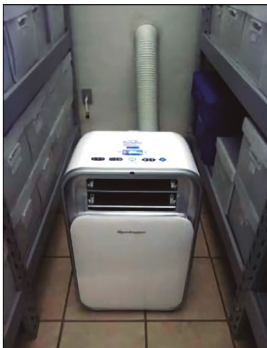
FIGURA 88 – Equipamento de ar-condicionado doméstico instalado na Sala A (provável causador do incêndio).
