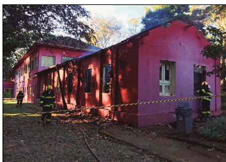
FIGURA 83 - Vista lateral da edificação incendiada.
