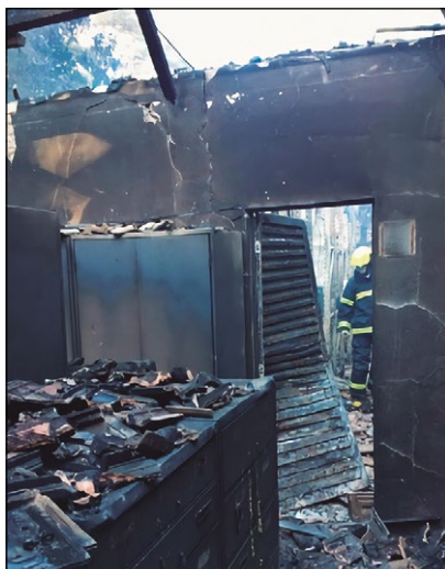
FIGURA 95 – Vista da sala C após a contenção das chamas pelo CBMMG.
