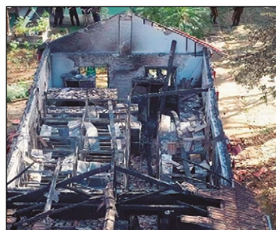
FIGURA 84 - Vista superior da Reserva Técnica 1 após o incêndio.
