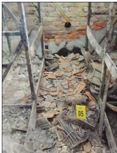
FIGURA 89 – Resíduos da área onde estava instalado o ar-condicionado doméstico na Sala A, com resquícios do aparelho identificados como item 05.
