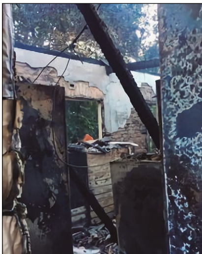
FIGURA 93 – Vista da sala A após a contenção das chamas pelo CBMMG. Fonte: Corpo de Bombeiro Militar de MG, 2020
